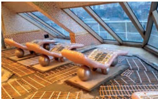
Installation pour Navire Costa Fascinosa de Costa Crociere
